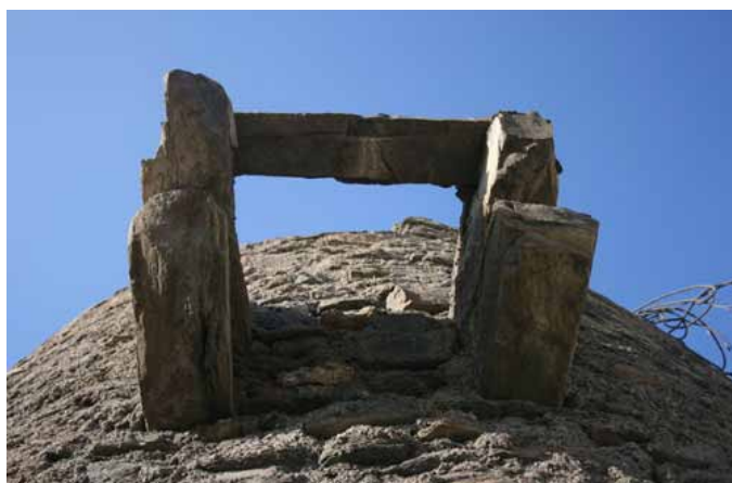
Lám. 19. Vistas de la ladronera desde la azotea y desde la base de la torre (Foto Gespad al-Andalus S.L.U. 2010).
