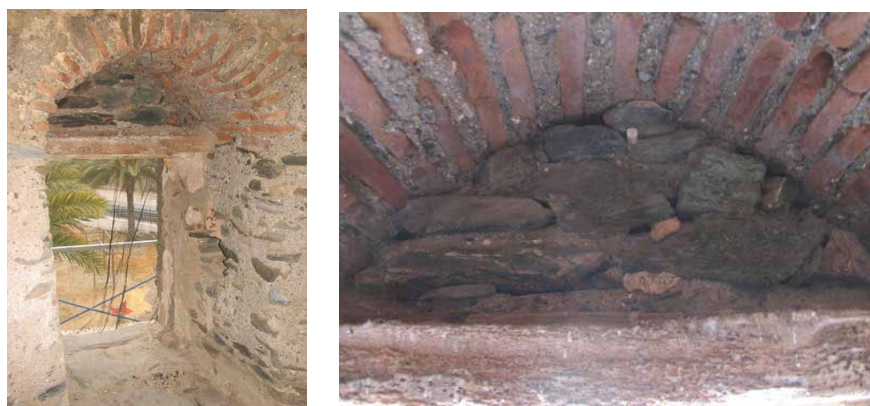
Lám. 13. Puerta de acceso vista desde el interior y detalle del dintel (Foto Gespad al-Andalus S.L.U. 2010).
