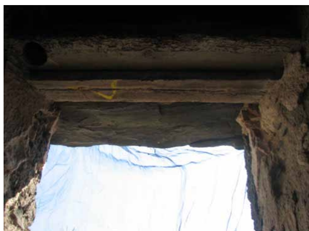
Lám. 14. Detalle de la gorronea del eje de la puerta (Foto Gespad al-Andalus S.L.U. 2010).
