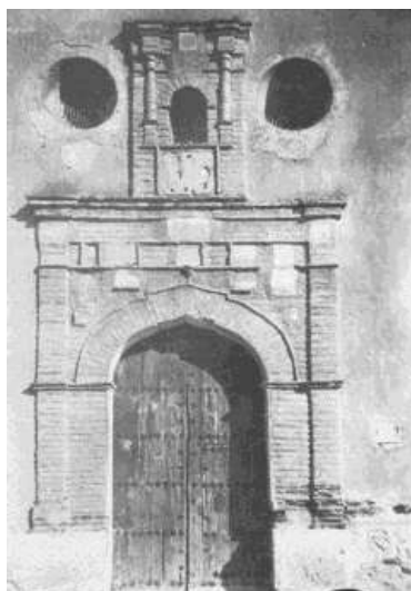
Lámina 6. Fachada de la Ermita de San Sebastián en el siglo XIX ( www.adraturismo.com ).
