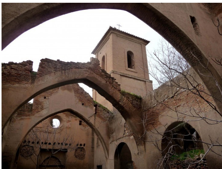
Lámina 5. Iglesia de San Luis, su estado actual desde el Interior.
